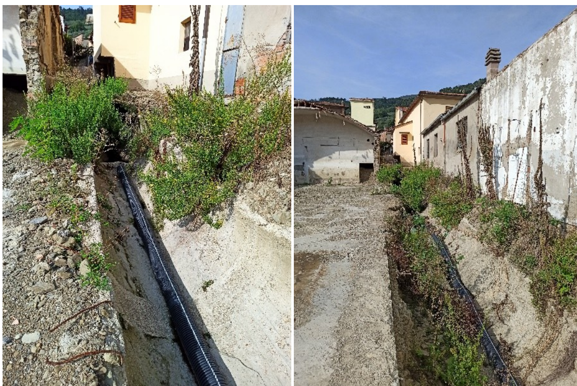
Figura 2.5. Parte residua della tubazione lungo l'area ex Dainelli, sopralluoghi tra settembre e ottobre 2025
